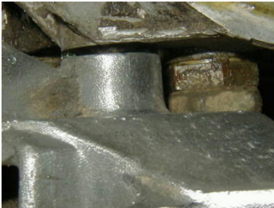
Hier sieht man die oberen Schraubenlöcher des Trägers. Normalerweise liegen diese ohne Spalt an. Dieses Maß muss an entsprechender Stelle abgenommen werden, damit keine Verspannungen beim Festschrauben entstehen.
